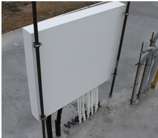
Montert skapstativ L2
