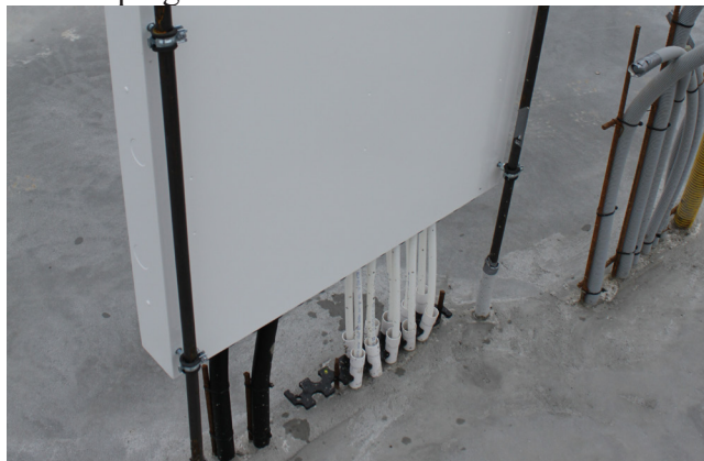
Montert skapstativ L2.
